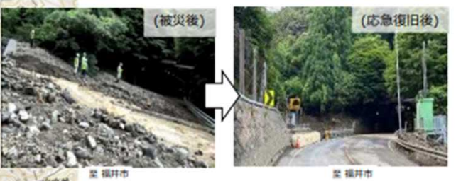
⑤国道8号敦賀トンネル 土砂流入
