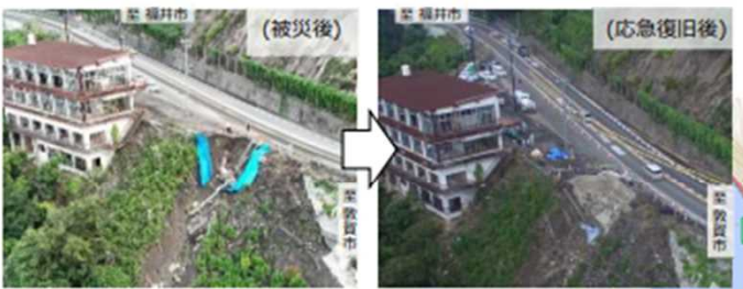
①国道8号福井県南越前町大谷 法面崩落
