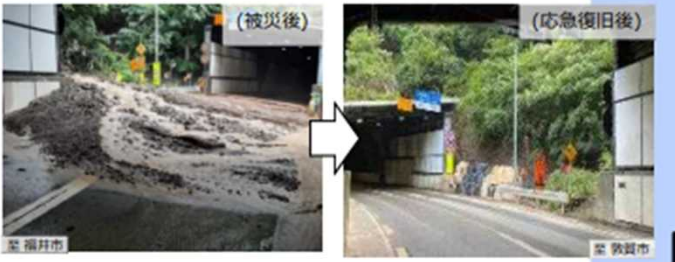
③国道8号大谷第2トンネル~第3トンネル間 土砂流入
