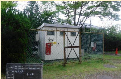
屋外にあった受変電設備
