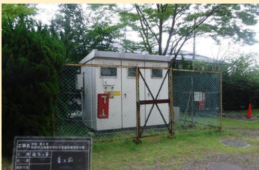
屋外にあった受変電設備
