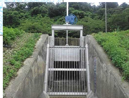
新たに設置した洪水吐ゲート
