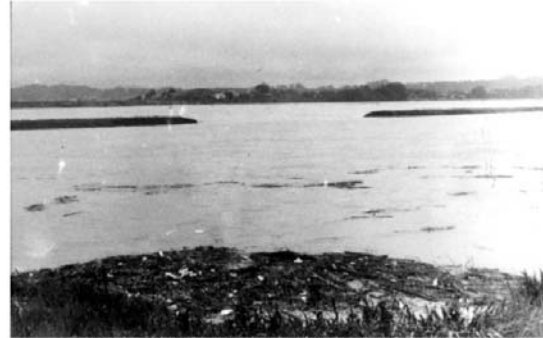
堤防破堤箇所(宮内地区)を右岸より望む 出典：秋田河川国道事務所資料
