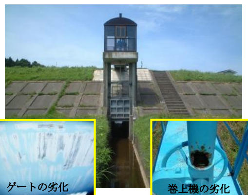
排水樋門と機械設備の劣化
