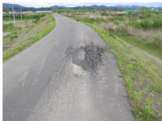
堤防天端の舗装の劣化状況
