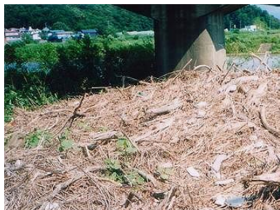
塵芥堆積状況
