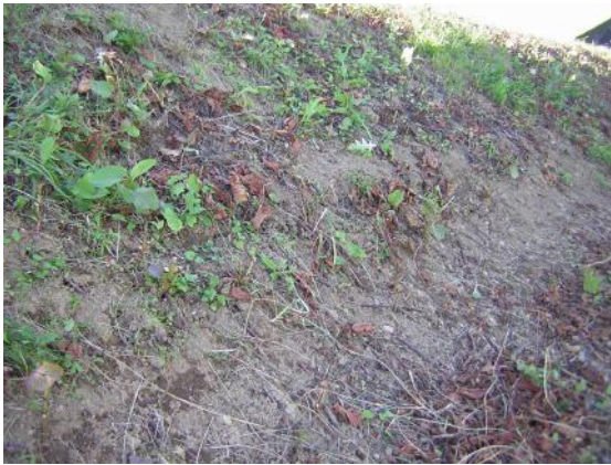
堤防の裸地化
