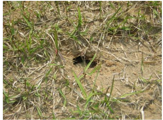
モグラ穴による堤防の損傷
