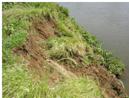
河岸崩壊の状況
