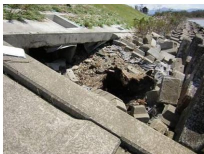
護岸の崩壊状況
