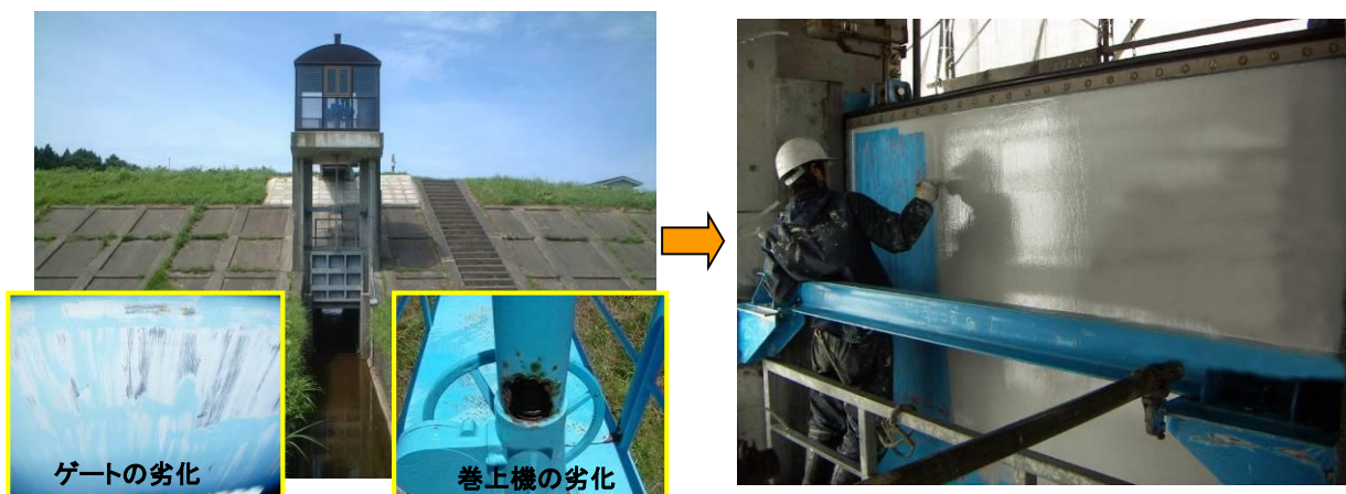
排水樋門と機械設備の劣化
