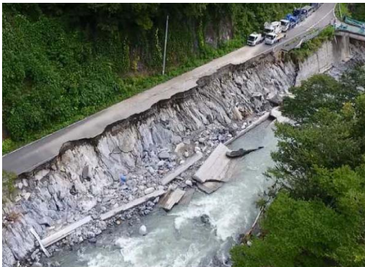
道路の崩壊(岩手県) (出典:国土交通省 台風による被災及び復旧状況 H28.9.27)
