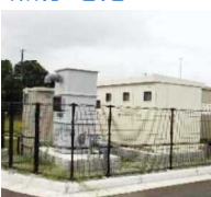
非常用発電機・蓄電池システム・移動用発電機
