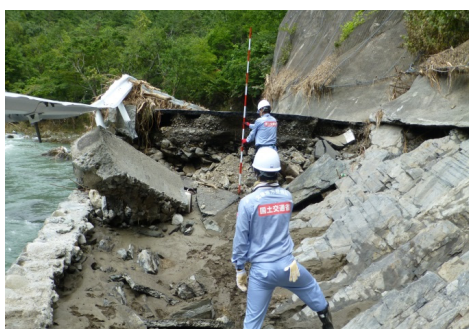
▲ 被災状況調査
