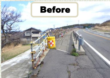
経年により老朽化していましたが...
