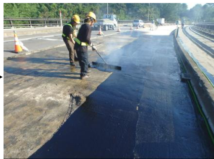
橋梁内部に水が浸透しないように防水材を塗布します。
