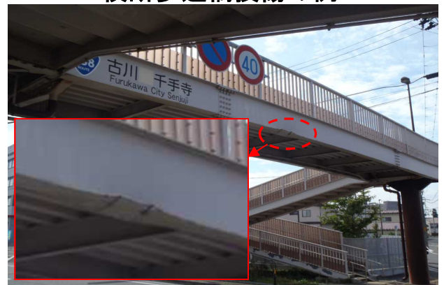
横断歩道橋損傷の例
