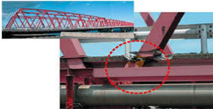
橋梁損傷の例 一般国道23号 木曾川大橋の鋼材破断
