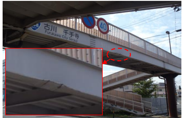
横断歩道橋損傷の例
