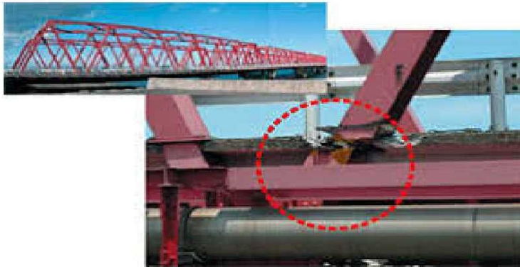
橋梁損傷の例 一般国道23号 木曽川大橋の鋼材破断
