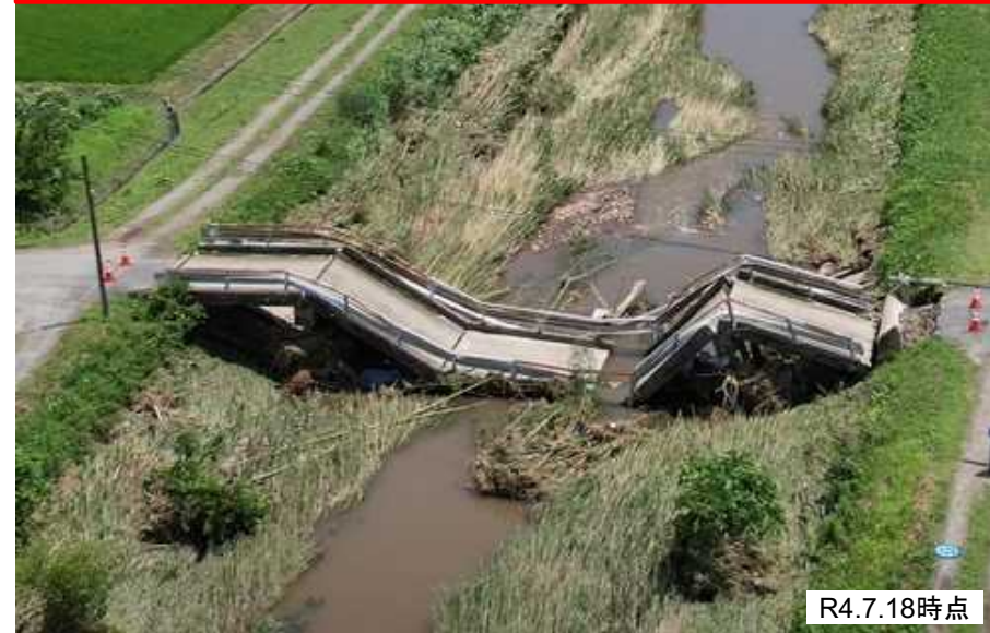
市道窪川原線 丸山橋 被災状況(崩壊)
