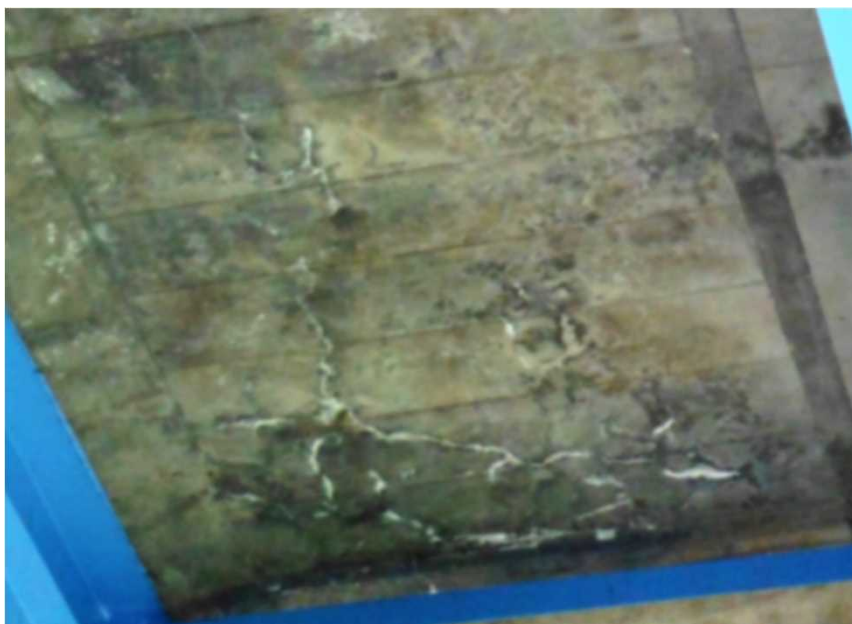
既設床版の劣化状況(下面)
