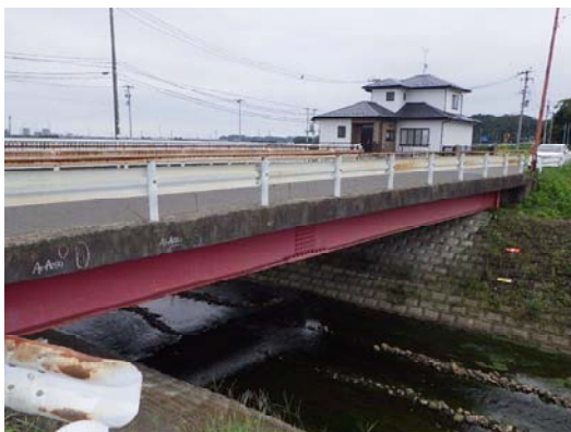
写真4-11 【損傷】 主桁の腐食、橋面劣化、防護柵腐食等
