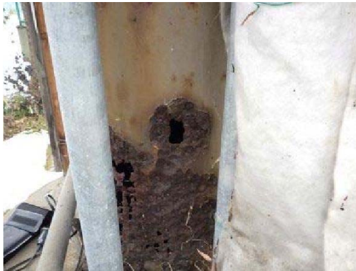
写真4-20 【損傷】 腐食、板厚減少
