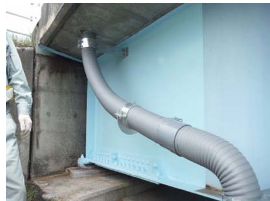
写真4-15 【対策】 当て板補修、排水管取替等
