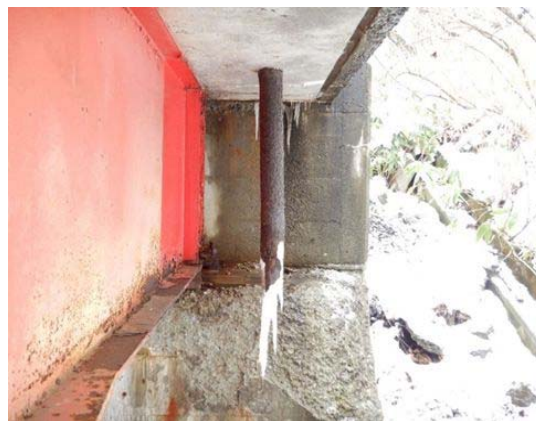
写真4-20 沓座部コンクリートの剥離
