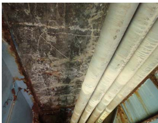
写真4-19 RC床版のひびわれ 錆汁を伴う漏水・遊離石灰
