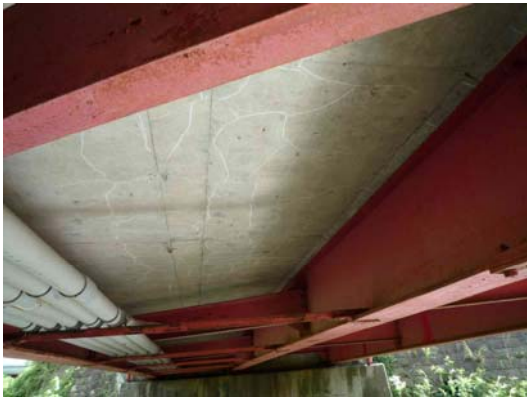
写真4-8 【損傷】床版ひびわれ
