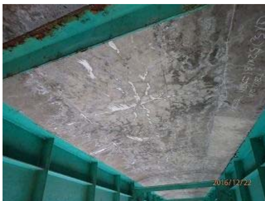
写真4-17 【損傷】 床版のエフロレッセンス、ひびわれ
