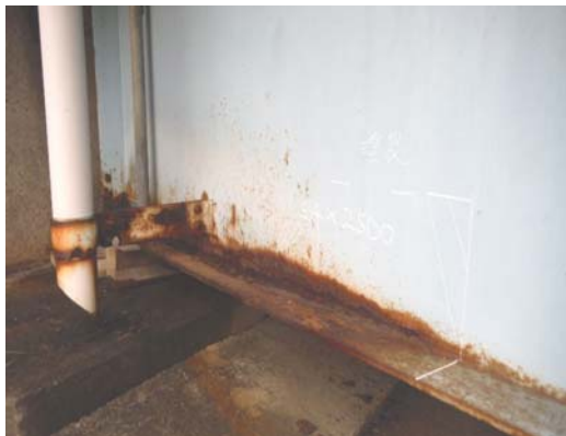
写真4-14 【損傷】 主桁端部の腐食
