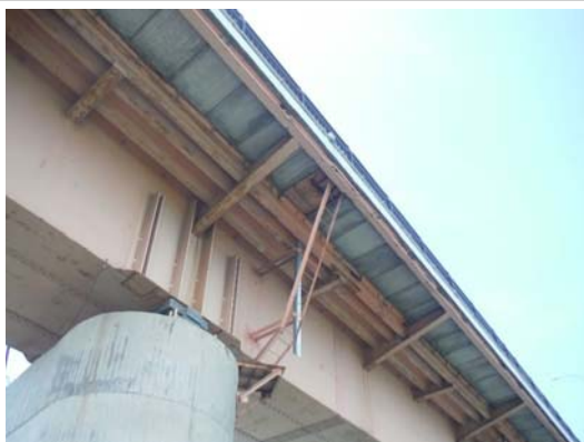
写真4-2 【損傷】 鋼部材の腐食及び防食機能の劣化
