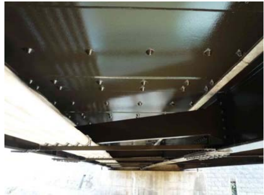
写真4-9 【対策】 鋼板接着工法、塗装塗替等
