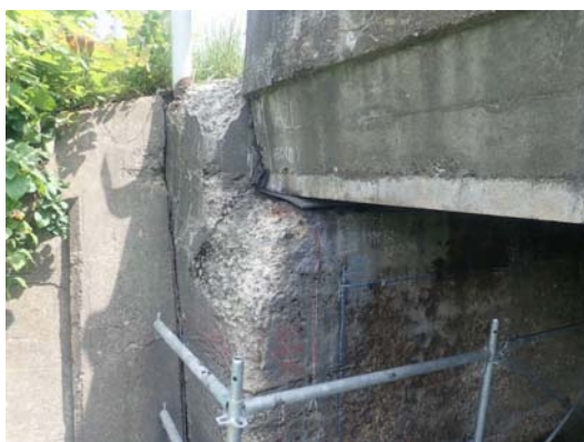
写真4-5 【損傷】 縦壁の剥離、鉄筋露出
