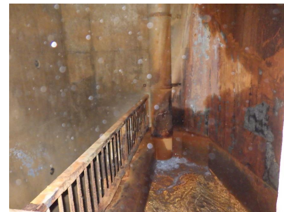
雨水吐口内堆積物 除去後 代表箇所
