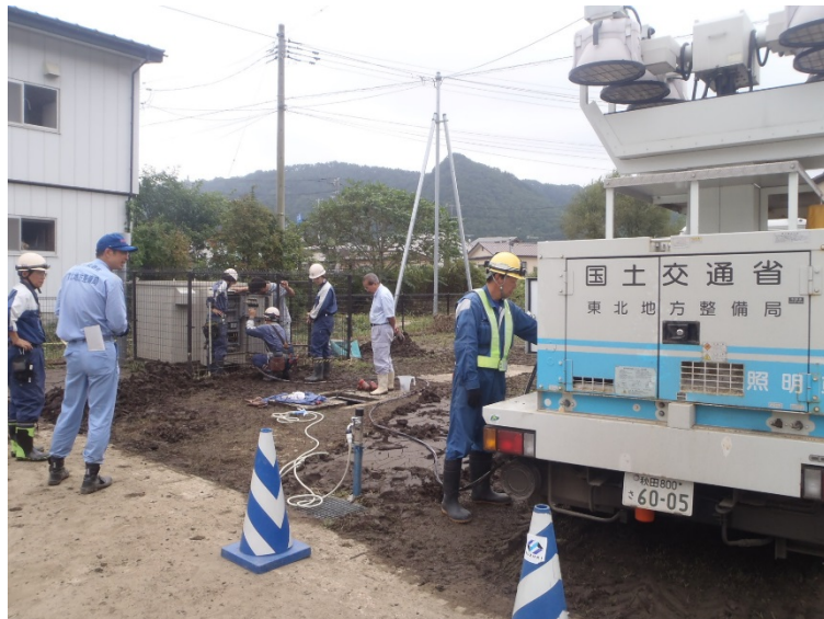
岩泉町 小本地区災害公営住宅 浄化槽ポンプ電源供給
