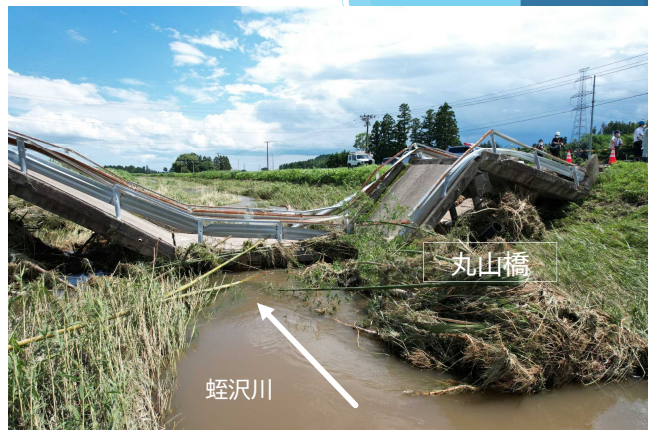
崩落した丸山橋(延長25m)
