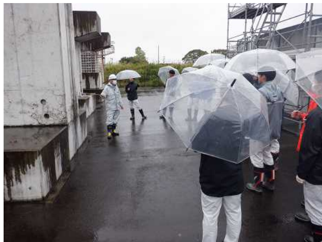
不適切施工について
