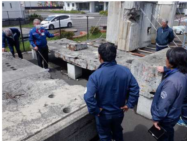
床版の劣化について
