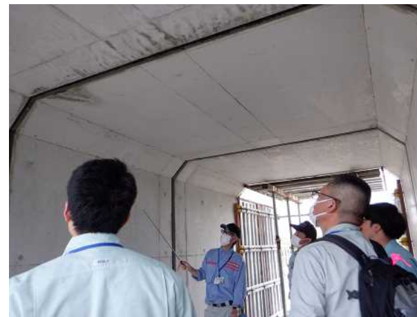
沈みひび割れについて
