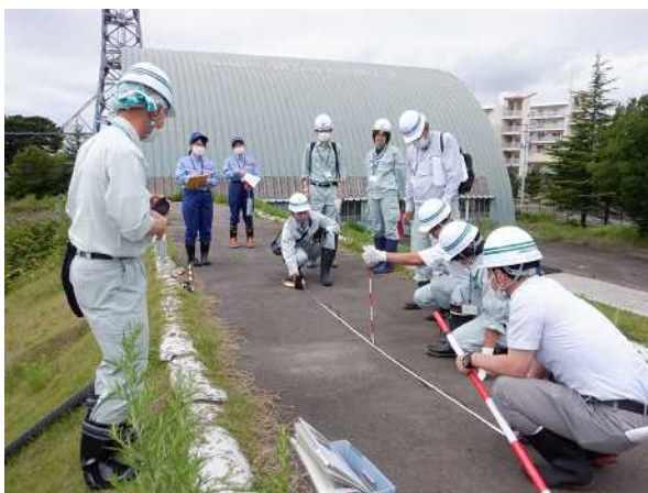
堤防の亀裂の計測
