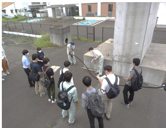
コンクリート打設で使用する バイブレーターについて学習
