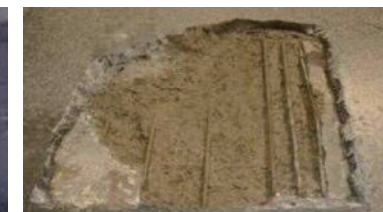
コンクリート床版の損傷 (土砂化)
