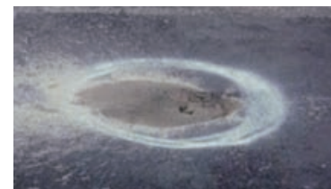
橋面舗装異常の状況
