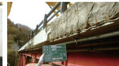
補修10年後の再劣化状況
