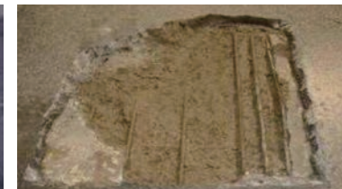
床版上面の土砂化
