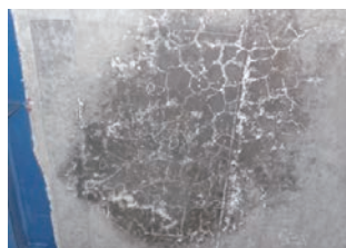
床版のひび割れ・漏水
