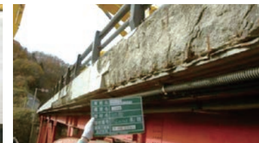
補修 10 年後の再劣化
