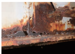
鋼橋桁の腐食・欠損
