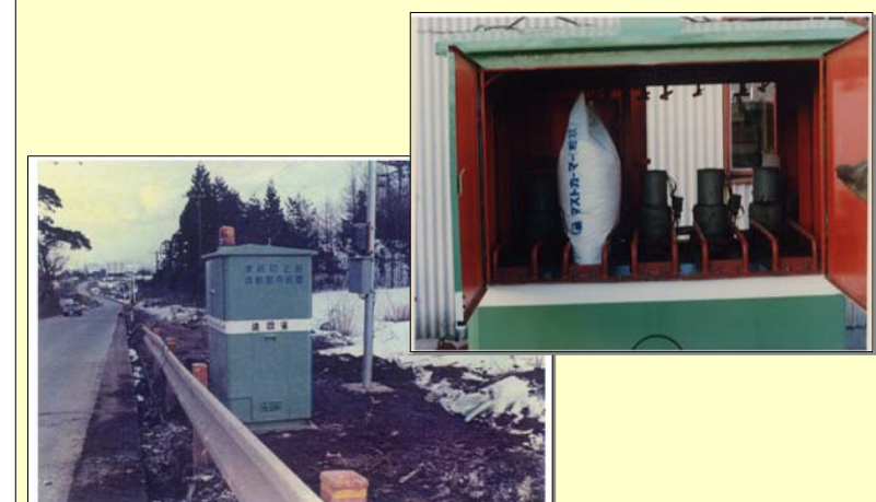
昭和50年 薬剤散布機製作(顆粒)設置
