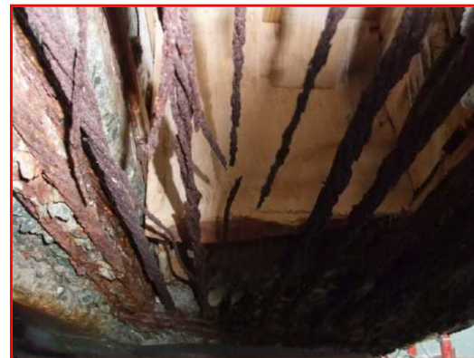
写真-3 鋼材の破断(桁下面)
