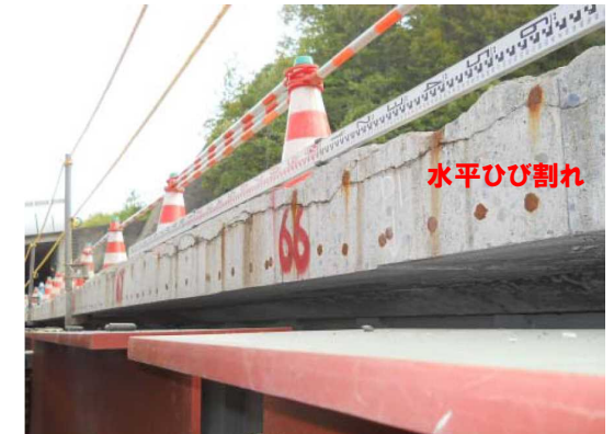
写真 下り車線側の水平ひび割れ(側面)
