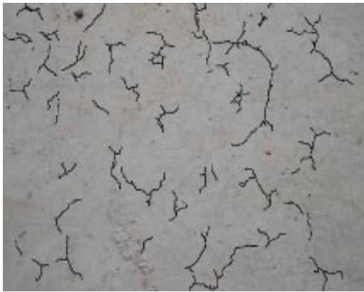
図-4.1 微細クラック発生状況
