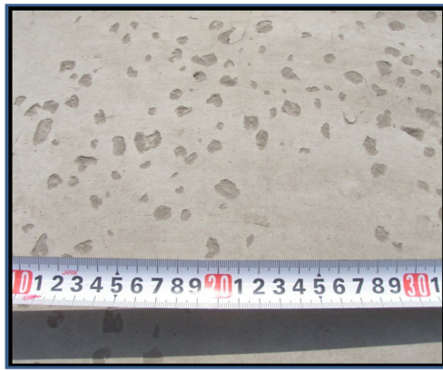
図-4.2 越冬 1 年後の表面剥離
