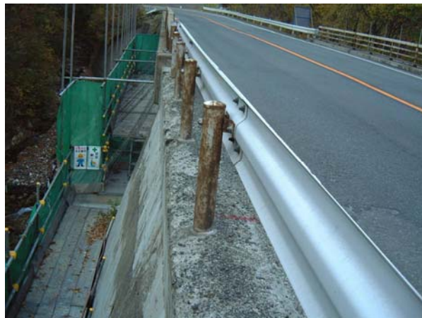
写真 4.1.1 実構造物におけるスケーリングの発生状況
