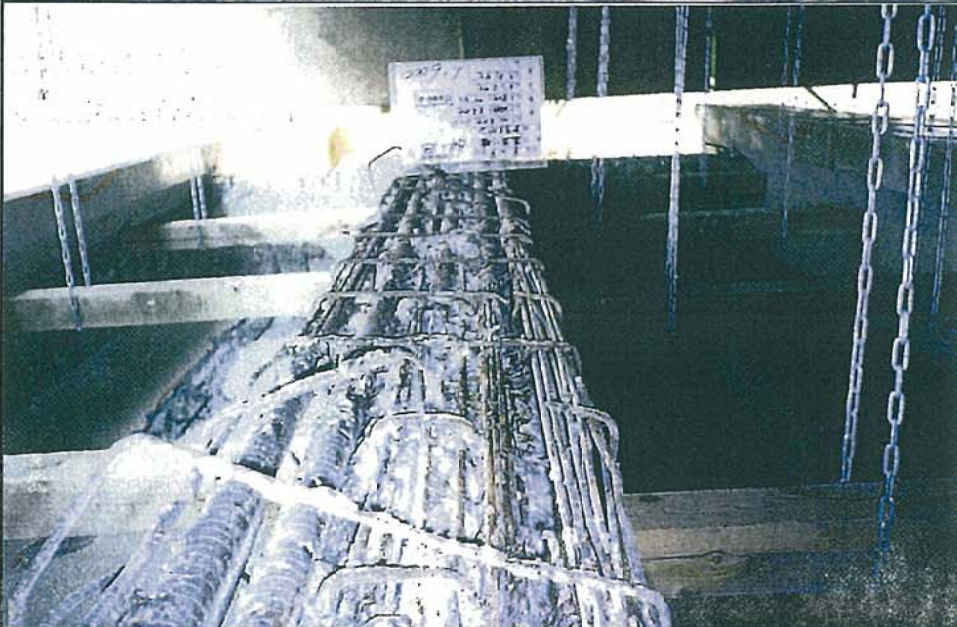
はつり後の PC鋼材腐食状況 (鋼材腐食度調査)
