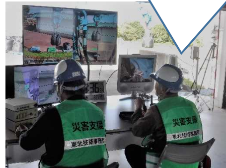
距離が50m以上であれば、モニターで確認しながら室内でバックホウをリモコン操作
