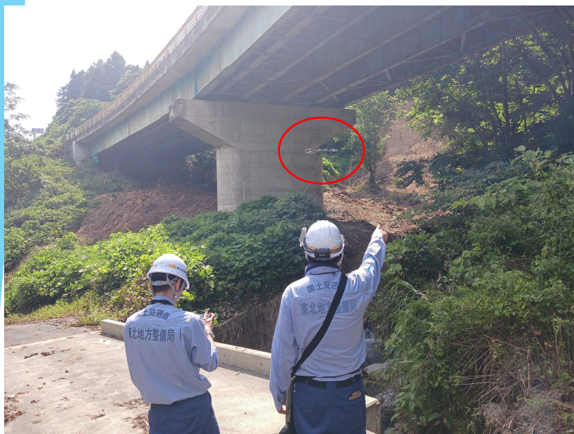
土砂崩落による現場調査(山形県舟形町長沢地区)
