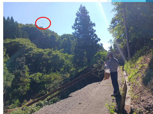
道路崩落による現場調査 (山形県鮭川村曲川下芦沢地区)
