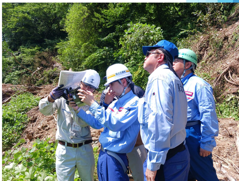
被災状況調査(水道状況確認) (山形県鮭川村根坂地区)
