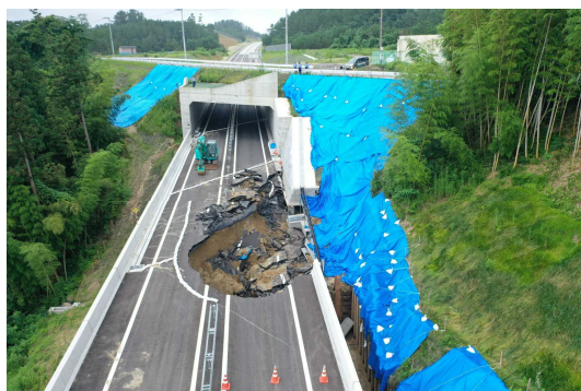
高速道路(日東道)崩落状況 (山形県遊佐町 日東道)
