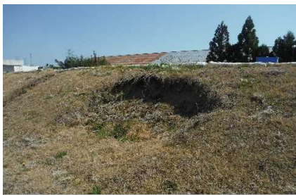
堤防法面の法崩れ
