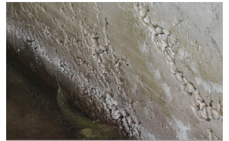
樋門函体の豆板
