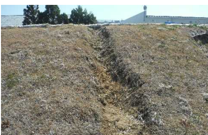
堤防法面の浸食(ガリ)
