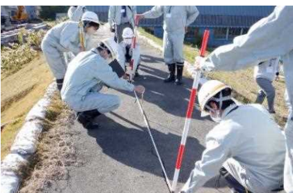
堤防天端の亀裂の計測
