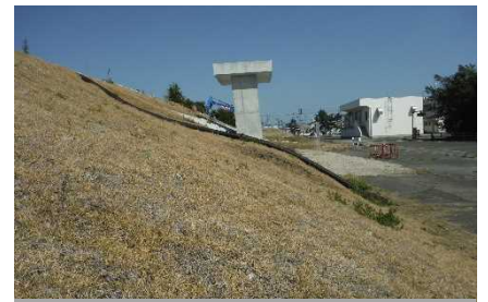
堤防法面のはらみ出し
