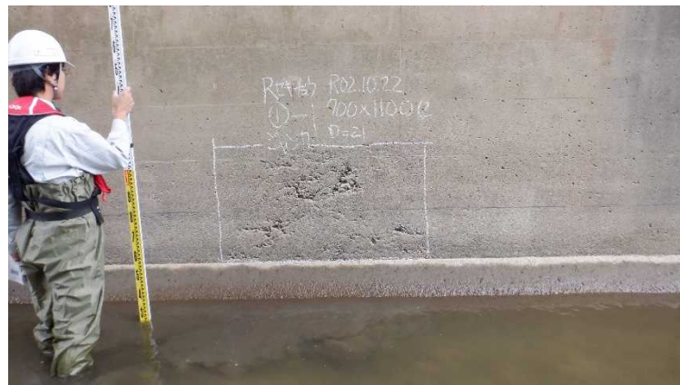
▲排水樋門内の変状箇所(豆板)確認
