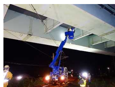
【軌陸車を利用した点検】 鉄道を跨ぐ線橋部は、レール上を走行しながら実施
