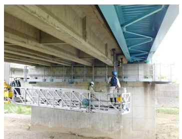
【橋梁点検車(歩廊式)】 桁下は、歩廊車に橋梁診断員が搭乗し効率的に実施
