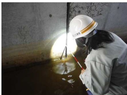
▲ 止水板の破断状況確認
