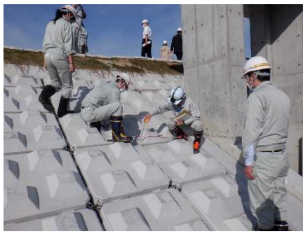
▲ 護岸ブロックの段差計測
