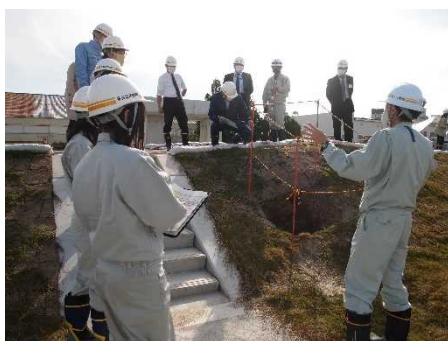
▲ 樋門周辺の陥没の確認
