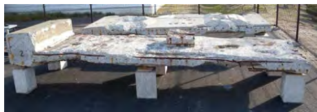
劣化したRC床版
