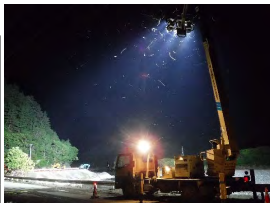
H28年台風10号 国道455号 岩手県岩泉町
