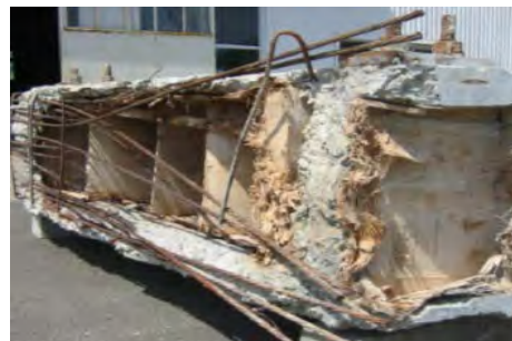
劣化したPC中空床版桁
