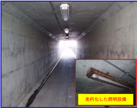
【薄暗く、防犯上好ましくない状況】
