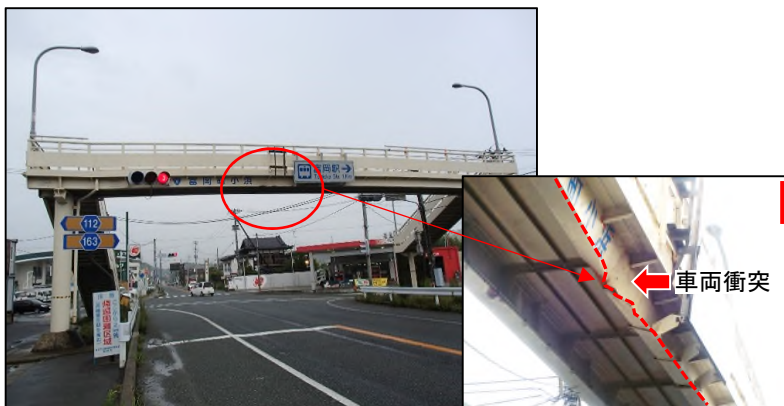
歩道橋の損傷(H29年7月)
