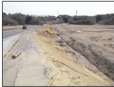
南相馬市原町区堤谷周辺
