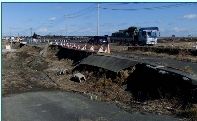
▲津波の被害により、歩道部分の盛土が崩れ、歩道の利用が制限されていることから、復旧工を行います。
