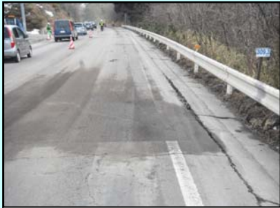
▲地震の揺れにより、路肩部分に亀裂が発生しています。
