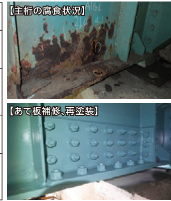
【全桁の腐食状況】
