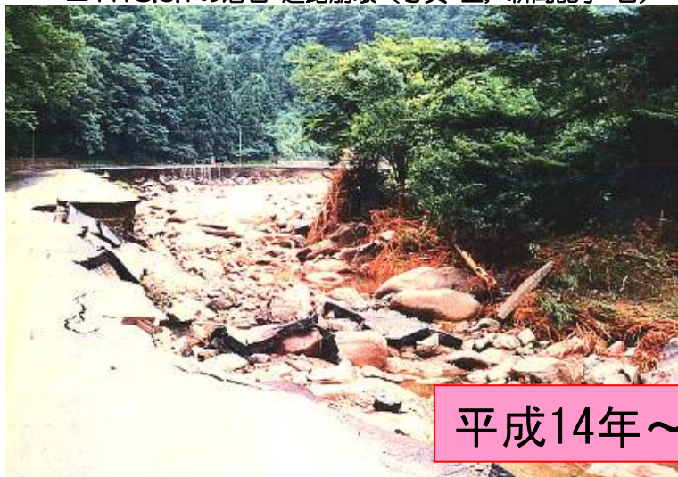
▲ 過去の道路崩壊状況
