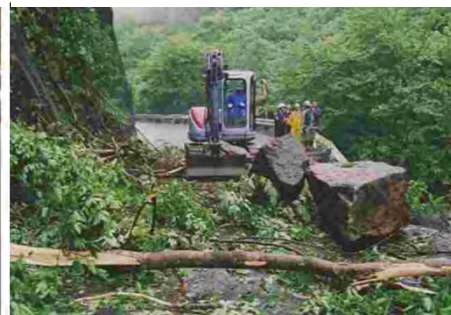
▼落石災害発生(H18)約1ヶ月全止
