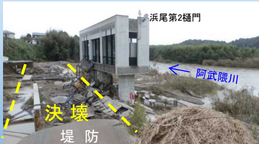
98.6k 左岸堤防決壊箇所(須賀川市)
