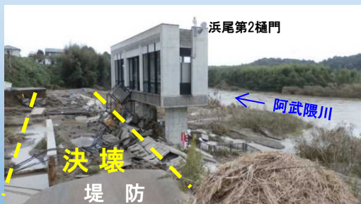
98.6k 左岸堤防決壊箇所(須賀川市)
