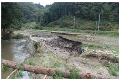
一級河川北須川の被災状況
